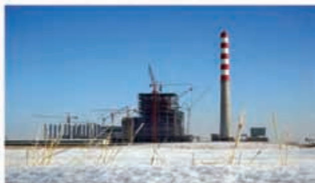
青海天峻电厂融雪工程
