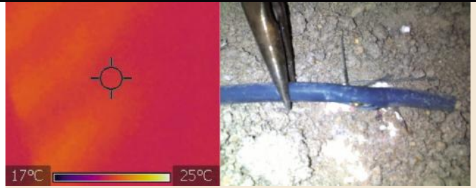
辽宁某工地用故障检测仪检测出短路点,刨开地面发现电缆外护套破裂,有明显的外力压伤的痕迹。
