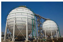
液化石油气罐氨气储槽底部等防冻保温。
