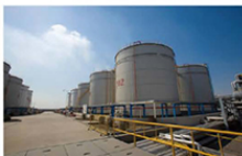
严格控制作业温度的液体管线伴热。
