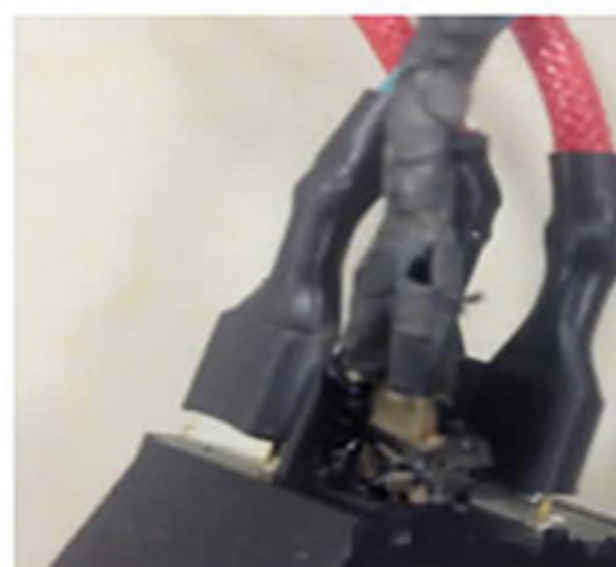
压接处温度过高导致电器件烧毁 (转下一页)
